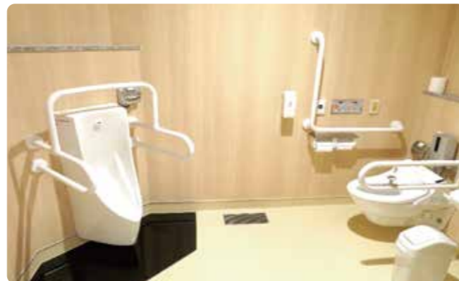
■車いす対応のトイレ
